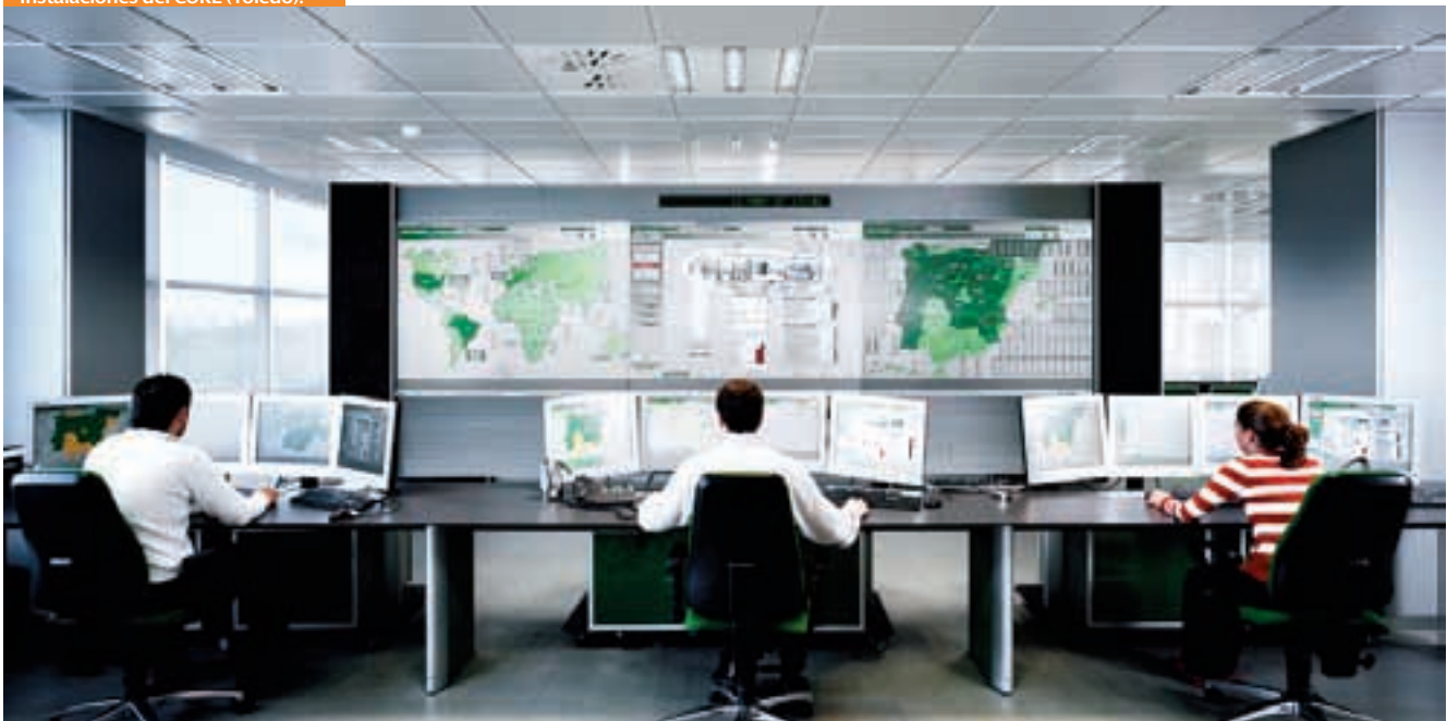
Instalaciones del CORE (Toledo).
